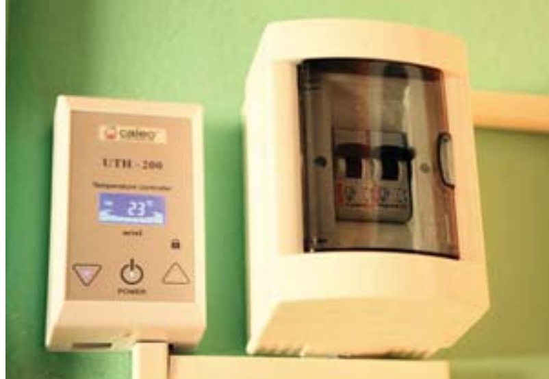
Рис. 26. Терморегулятор, подключенный к сети через отдельный автомат
