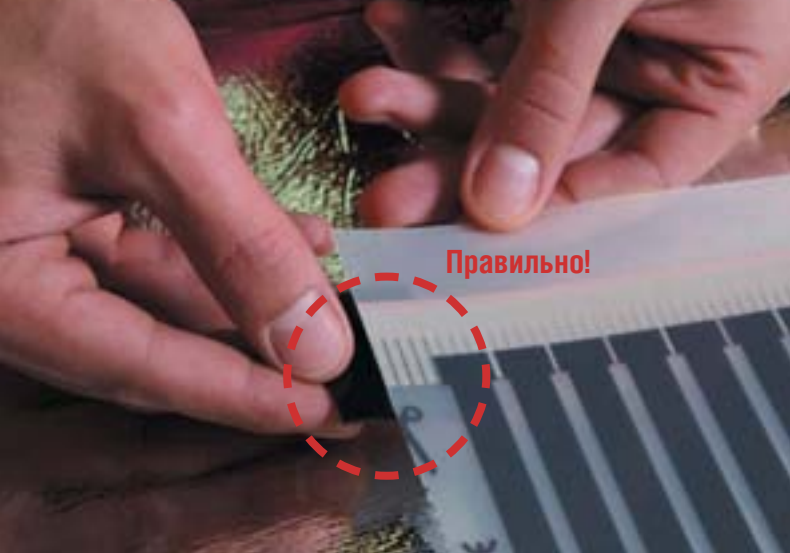
Рис. 10. Пример правильной установки изоляции линии отреза медной шины
